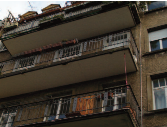
Die alte, verkommene Fassade vor der Sanierung.
