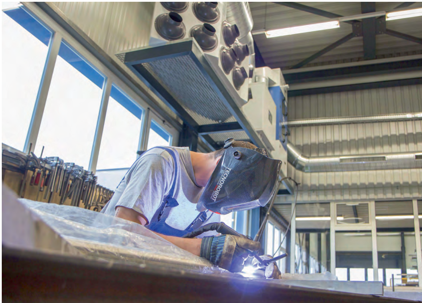
Auch der Schweissrauch wird bestens abgezogen. Même les fumées de soudage sont parfaitement aspirées.
