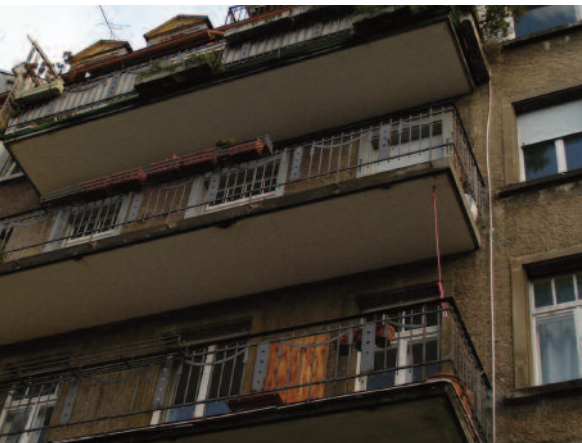
Die alte, verkommene Fassade vor der Sanierung.
